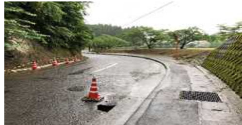
【大雨による通学路の陥没】
