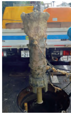
油脂が付着したパンホールポンプ
