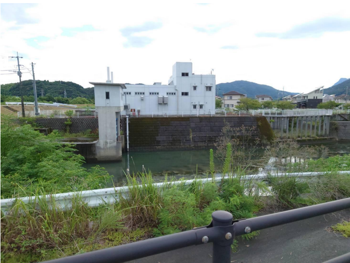
排水ポンプ場
