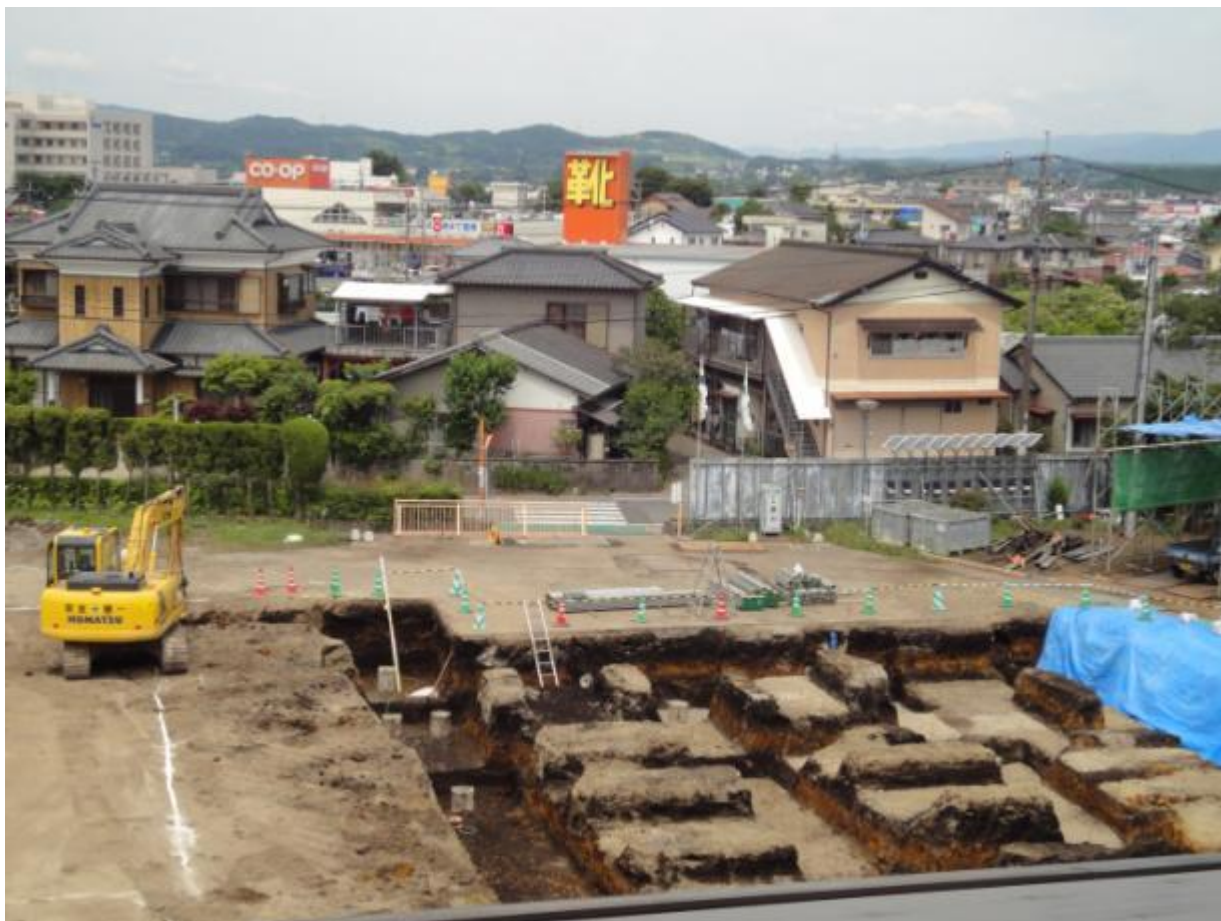
ショベルカーでかなりな深さまで掘り、生コンを流し込んでの基礎づくりのための準備が始まりました。
