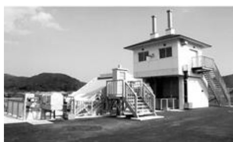
北川の排水ポンプ
